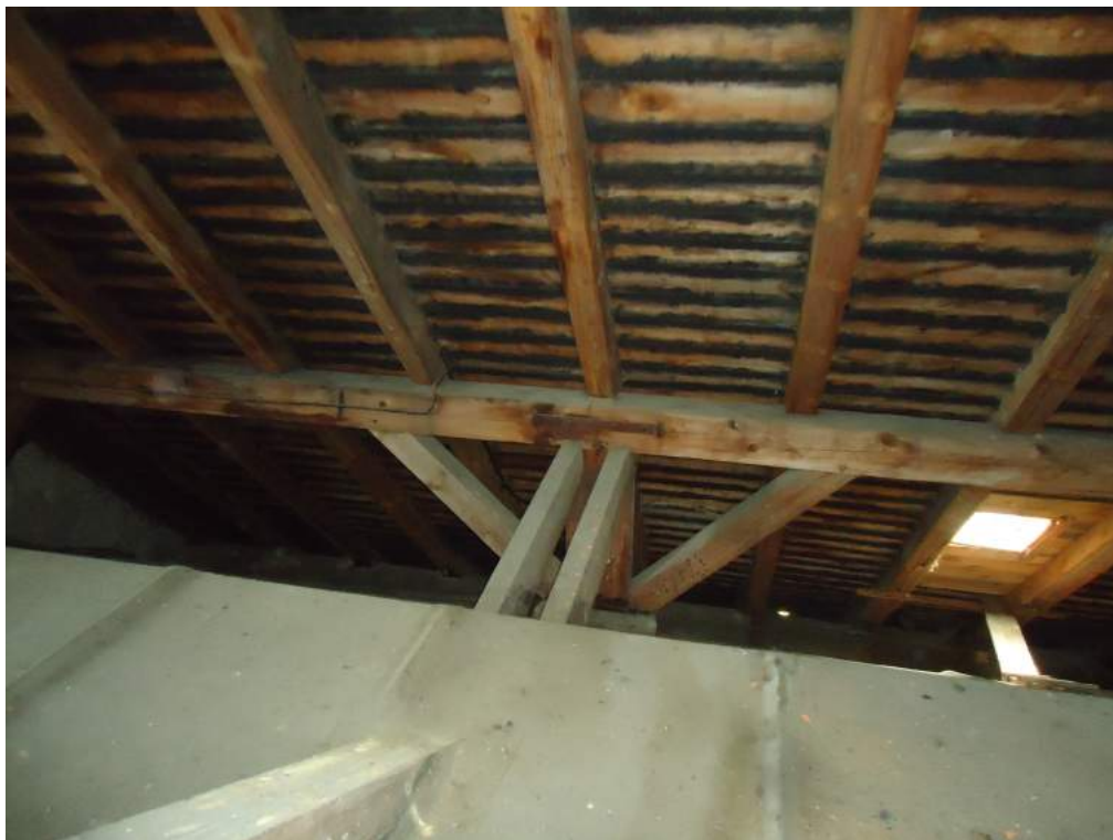
37. Widok deskowania prowizoryczne zabezpieczenie przed przeciekami.
