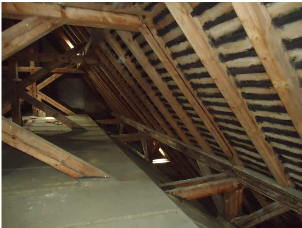
38. Widok deskowania prowizoryczne zabezpieczenie przed przeciekami, płatwi i pod konstrukcją widoczne działania drewnojadów, widoczne ślady mączki.
