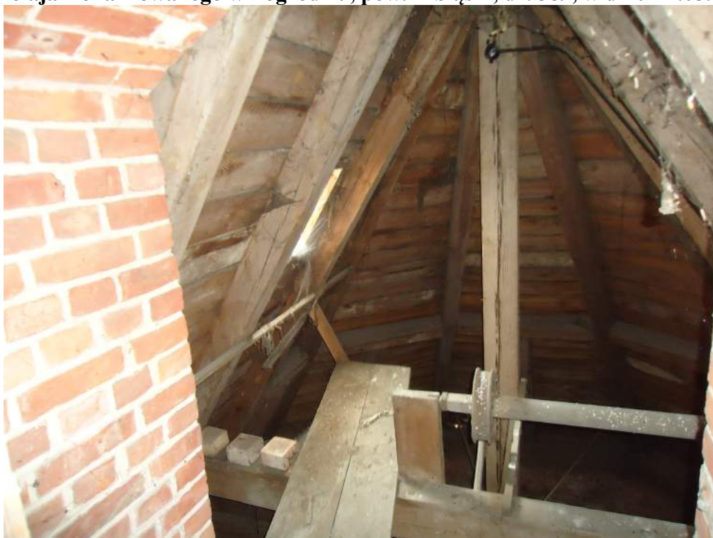
45. Widok zakrystii konstrukcja drewniana do remontu, deskowanie do wymiany
